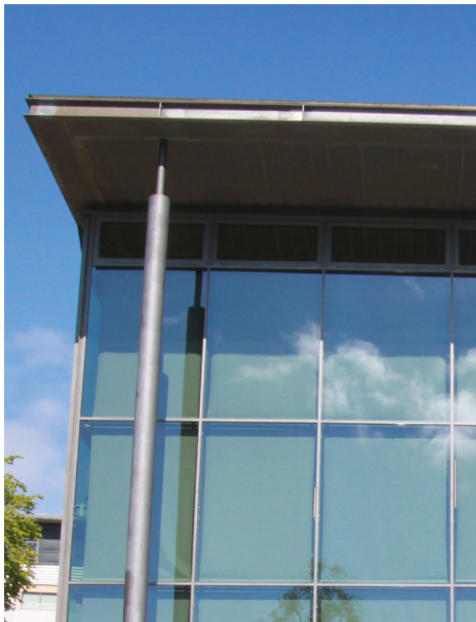
Eksempel på prosjekteringsfeil kan være at man bygger en fasade med takutspring eller baldakiner, som skaper skygge på deler av glasset, uten at det er tatt hensyn til varmeabsorpsjon.
