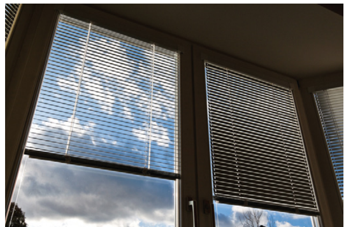
Eksempel på feil bruk kan være innvendige persiener som dekker deler av glassflaten, uten at det er tatt hensyn til varmeabsorpsjon.
