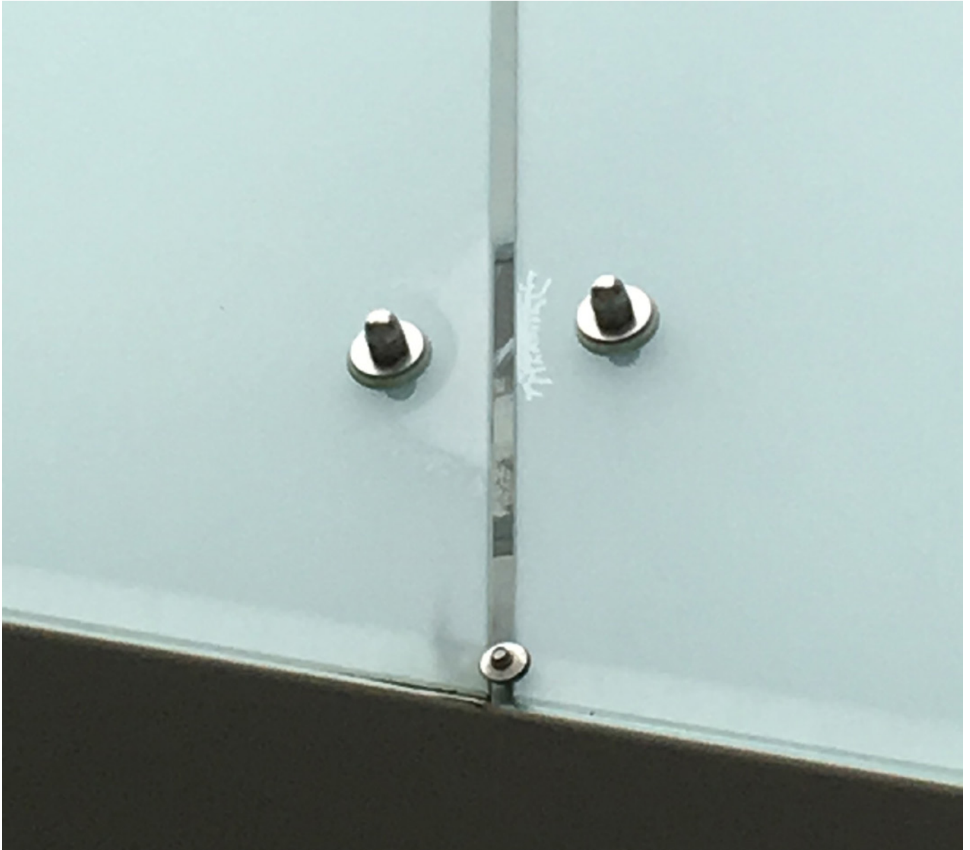
Bilde 4: Delaminering i området rundt punktfixerte skyldes ofte feilposisjonering av hull og/eller for hard tilstramming. Se også bilde 2.
