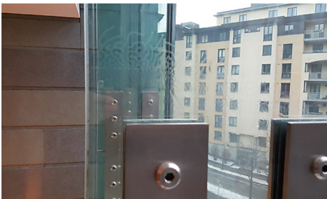
Bilde 2: Eksempel på delaminering typisk for montering med for hard tilstramning av festepunkter.
