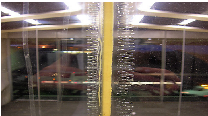
Bilde 5: Eksempel på delaminering som skyldes fugemasse som ikke er kompatibel med laminatfolien i glasset.
