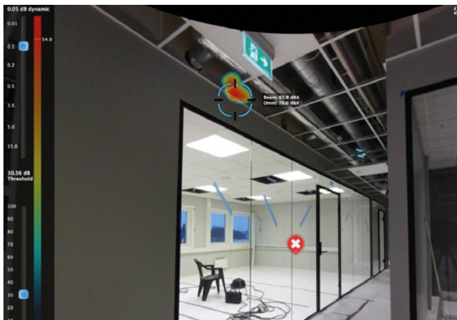
Test 3: Glassvegg i møterom med R'_w krav=34 dB. Lekkasje i skjørt. Det kan ofte være lekkasjer i forbindelse med gjennomføringer (El., Vent. og sprinkel). Se lydcurve.
